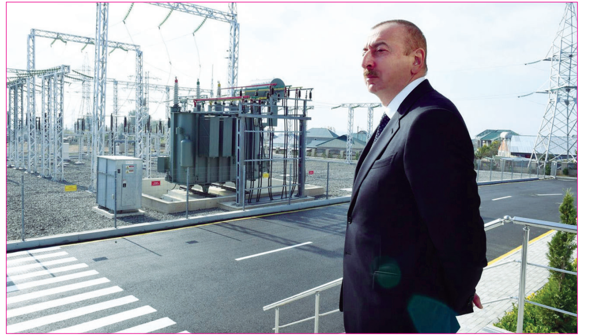
Prezident İlham Əliyev Qəbələ elektrik yarımstansiyasında yenidənqurmadan sonra yaradılan şəraitlə tanış olub.
